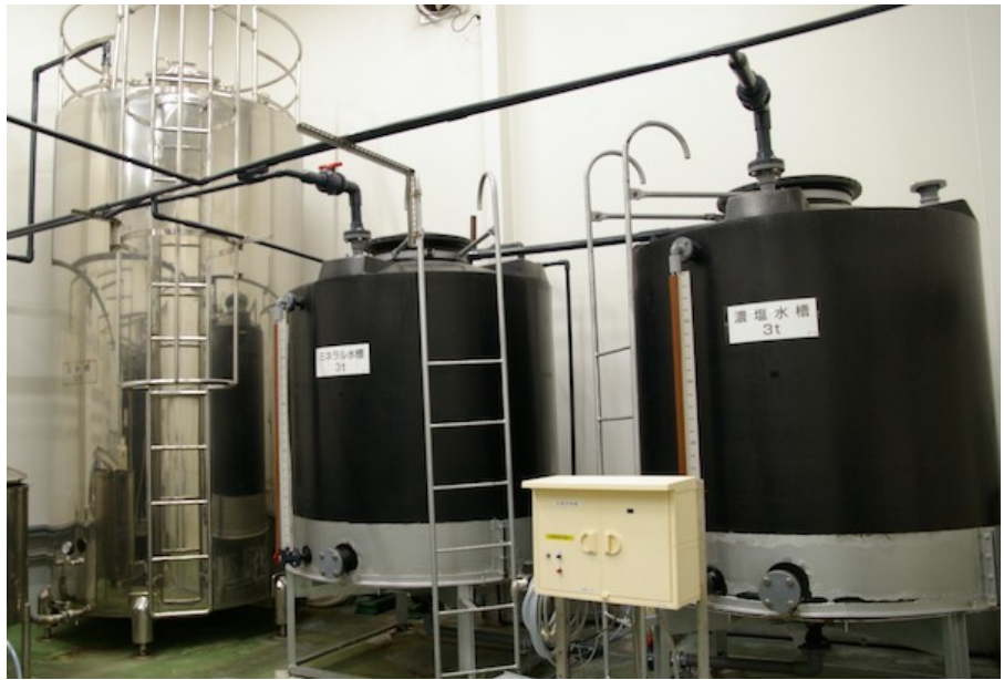
海洋深層水を脱塩水とミネラル濃縮水、濃塩水に分けた3タンク。タンクの設置されている室内は通常、外部からの光が遮断された暗室になっている。
